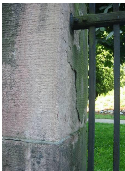
Meget tydelig afbladning af sandstensens overflade
