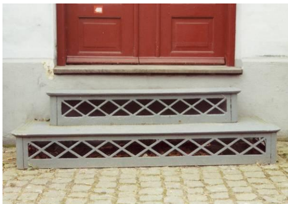
En enkel og prunkløs støbejernstrappe – der kunne være udført i nyt design.
