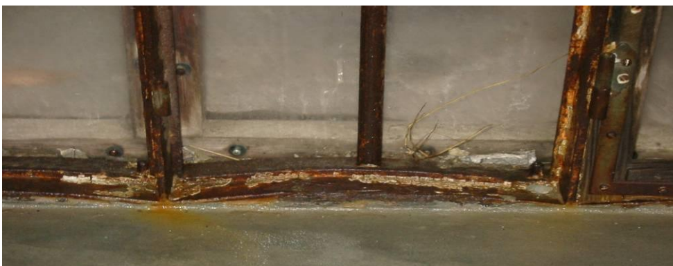
Fase 3: Svær korrosion hvor rusten er helt gennemtrængt i jernet med svære delaminationer ("afbladning"), opboblinger samt helt borttærede dele. Ved afbladningen 'vokser' jernet ca. 3 gange i rumfang. 1 mm bliver til 3 mm.
