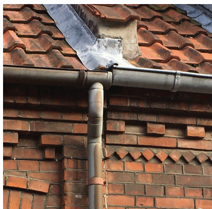
Nedløbsrør og tagrende i zink.
