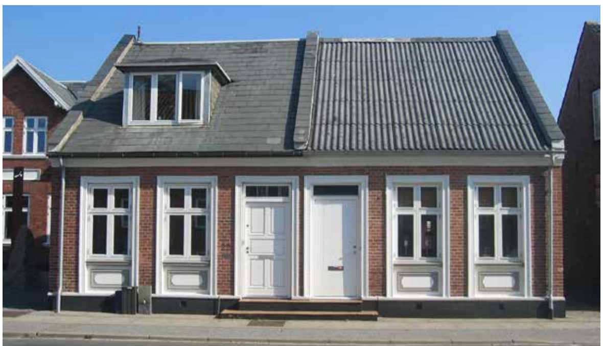
Den ene del af dette dobbelthus har beholdt sit oprindelige skifertag, mens den anden del har fået et nyt eternittag. Dette fremmer ikke bevaringsværdierne. Begge har fået nye, men forskellige døre, men trappen har man dog kunnet enes om.
