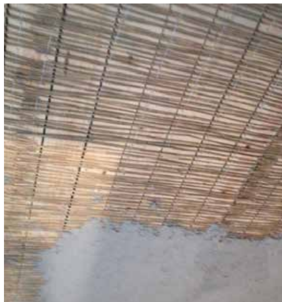
Når lofterne før i tiden blev pudset med kalkmørtel på rørvæv og derefter limfarvet med 'mosfarve', virker loftfladen som en god 'fugtbuffer', idet materialerne er poreåbne og derfor fugtabsorbierende. Hvis de pudsede lofter plastikmales, mister man denne klimaregulerende effekt.
