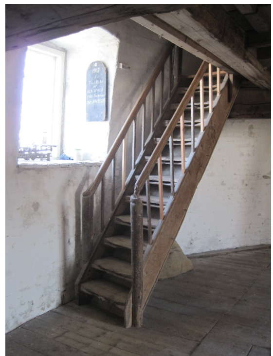
Meget slidt mølletrappe på Dyrehave Mølle i Nyborg, der er vurderet til at være en væsentlig del af de bærende bevaringsværdier
